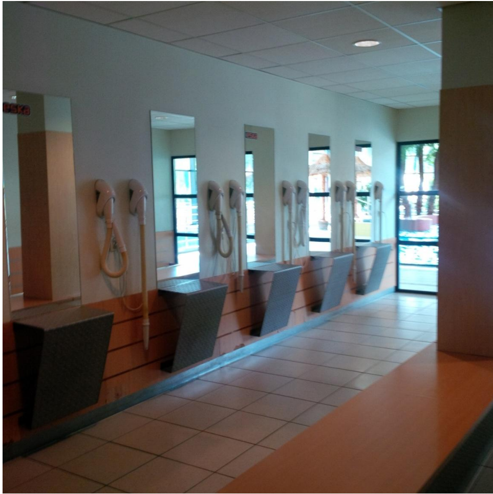
POMIESZCZENIE Z SUSZARKAMI DO WŁOSÓW
